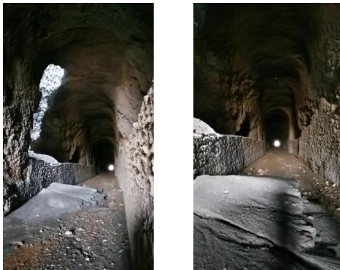
Desprendimientos en el interior del túnel del Barranco de La Mina
